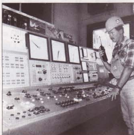
Steuerpult der Mischanlage.
